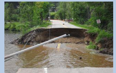
Effondrement de la route 307 à Bowman en raison des secousses
