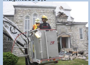
Une partie de l'Église de la Visitation de Gracefield s'est effondrée à la suite du tremblement de terre
